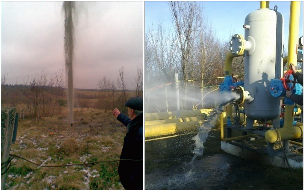
Рисунок 1.8 – Аварійний випуск газу і рідини в атмосферу з порожнини газопроводу у випадку припинення газопостачання з причини утворення великих рідинних скупчень
