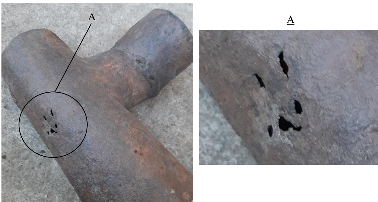
Рисунок 4.34 – Трійник тепломережі з наскрізними дефектами
