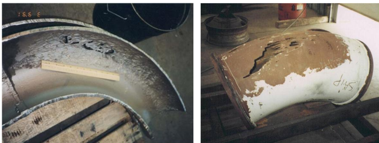
Рисунок 1.12 – Ерозійно-зношені відводи трубопроводів
