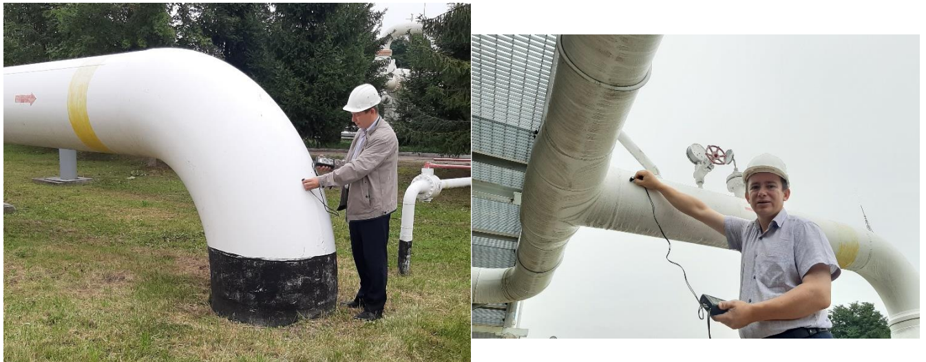
Рисунок 4.32 – Ультразвукове обстеження відводів, трійників обв'язки компресорної станції магістрального газопроводу
