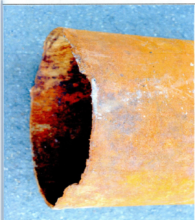
Рисунок 5.1 – Вигляд зруйнованого аварією зварного шва
