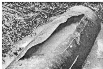
Рисунок 4 – Зруйнована ділянка труби
