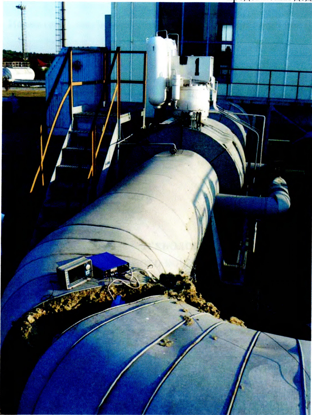
Рис. М.19 – Трубопроводи об'язки компресорної станції 37 "Бар", газокомпресорний агрегат № 1
