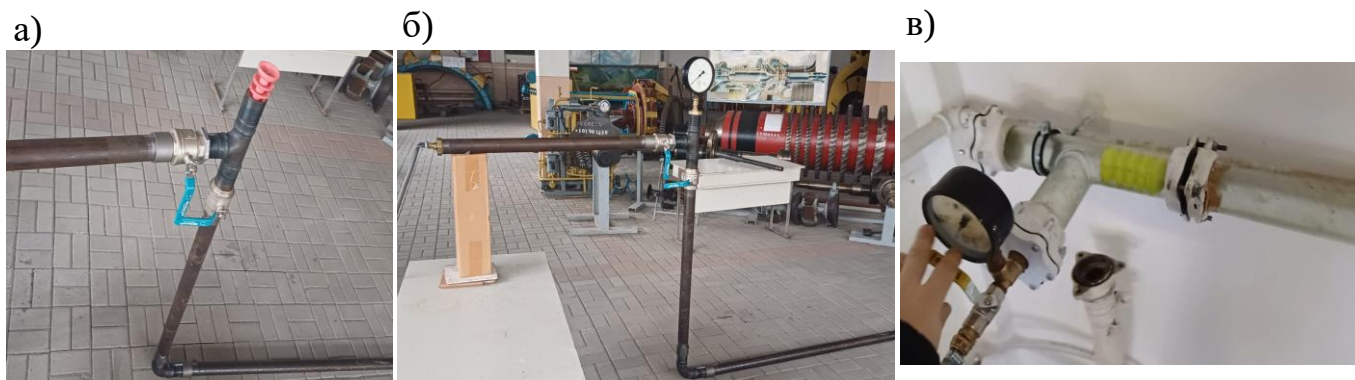
а) – запасування очисного поршня; б), в) – запускання очисного поршня Рисунок 39 – Стаціонарний вузол запускання очисних поршнів у трубопровід
